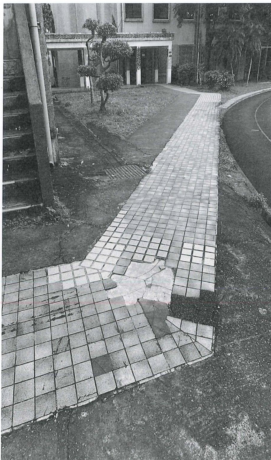
1090415 廣設_前方與操場跑道間步道，地磚脫落
