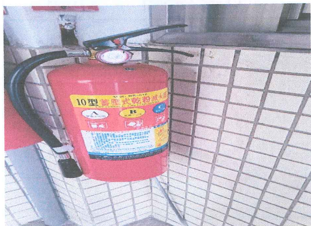
乾粉滅火器新品更換完成
