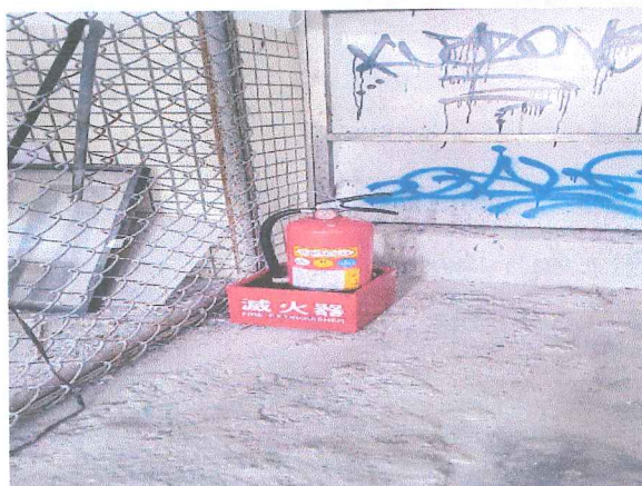
滅火器放置盒擺放完成
