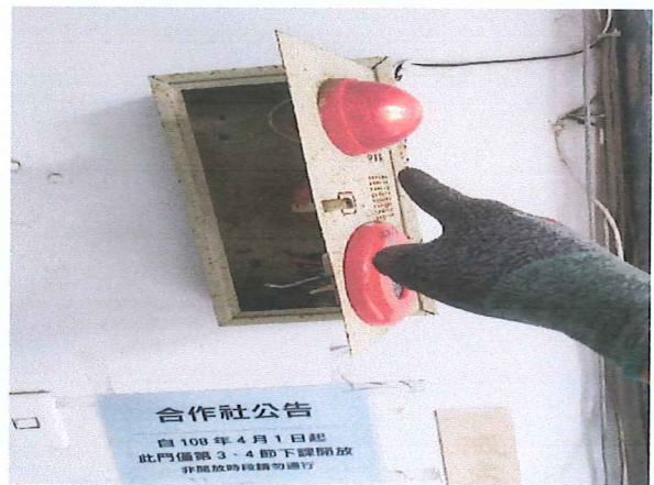
火警標示燈回路送電恢復正常
