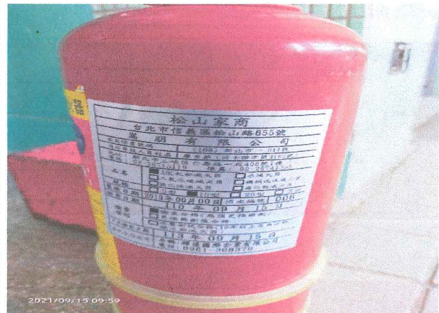
滅火器性能檢查完成送回放置
