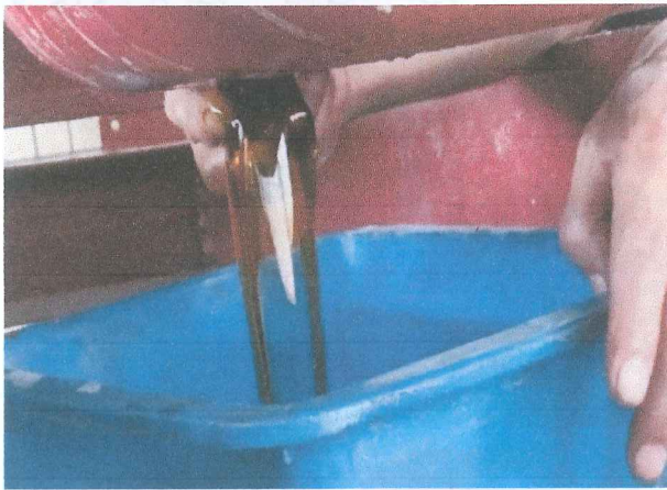
發電機引擎廢機油洩漏
