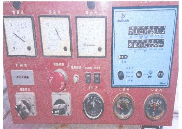
發電機組試運轉無異常
